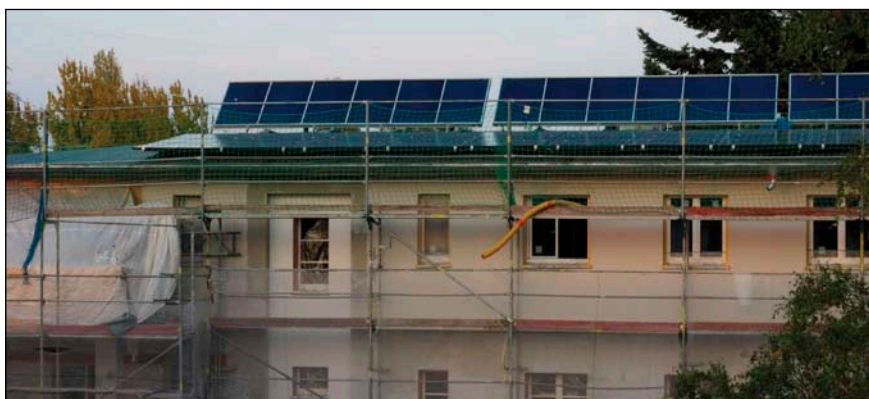
Bild 2: Sonnenenergie vom Dach: aufgeständert die Solarkollektoren und flach die PV-Module
