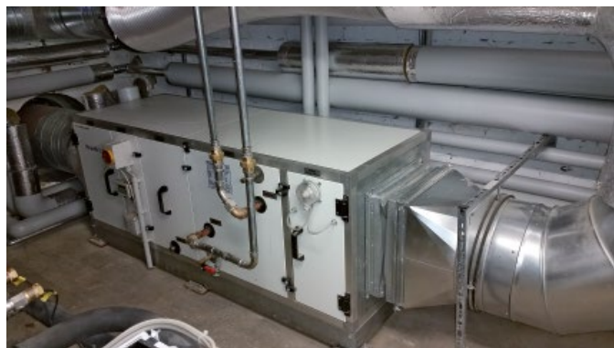
Bild 6. Abluftanlage mit Wärmepumpe und einer Jahresarbeitszahl von 6 bei 50 °C Vorlauftemperatur (Bilder 4, 5, 6: eZeit Ingenieure)
