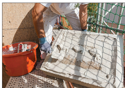
Geübte Praxis: Hanfdämmplatten von Caparol werden nach der Wulst-Punkt-Methode mit Armiermörtel versehen, ...
